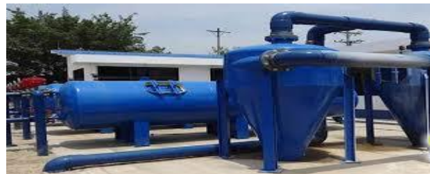
Empresa de acueducto
